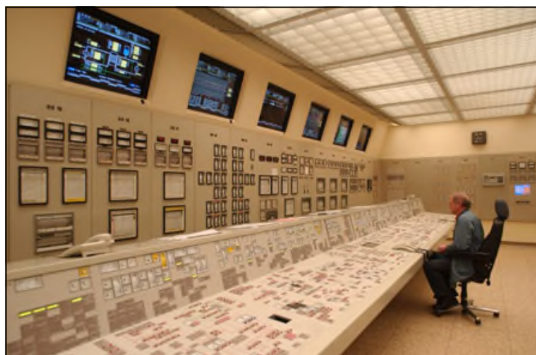
Der zentrale Leitstand des AKW Obrigheim, von dem aus das Kraftwerk gesteuert und überwacht wird © BMU / Bernd Müller
